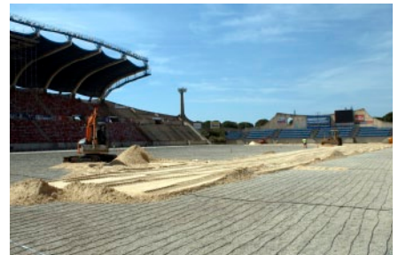
Stade de la Méditerranée Béziers Câble chauffant
