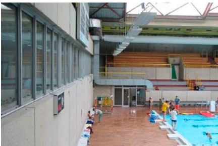
Piscine Panneau rayonnant
