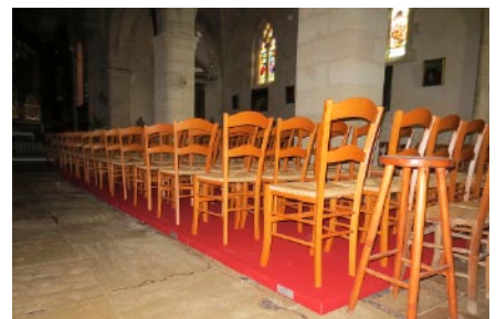
Eglise de Cambes Panneau de sol chauffant Dynasun
