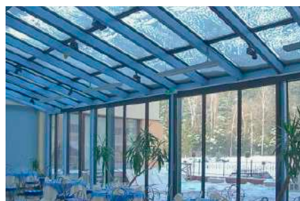
Restaurant , Russie Panneaux rayonnants
